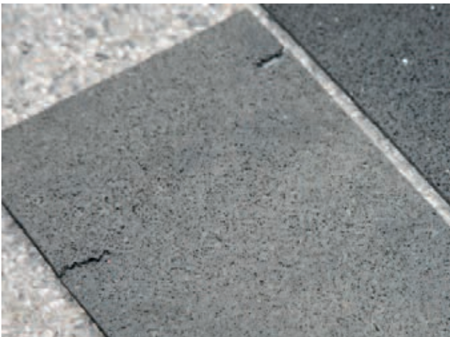
Ablegereife: verschmutzte Oberfläche und ausgebrochene Stellen
