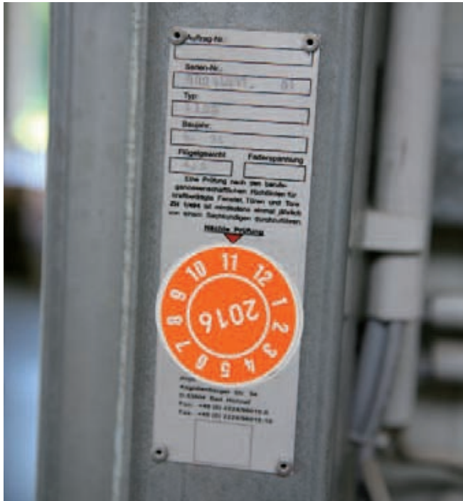
Prüfsiegel an einem elektrischen Rolltor
