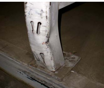
Abb. 12 Gerissene Schweißnaht an der Fußplatte der Stütze
